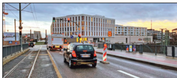
Weil die Verkehrssicherheit nicht mehr gewährleistet ist, muss die Czernybrücke kurzfristig saniert werden. Foto: han
